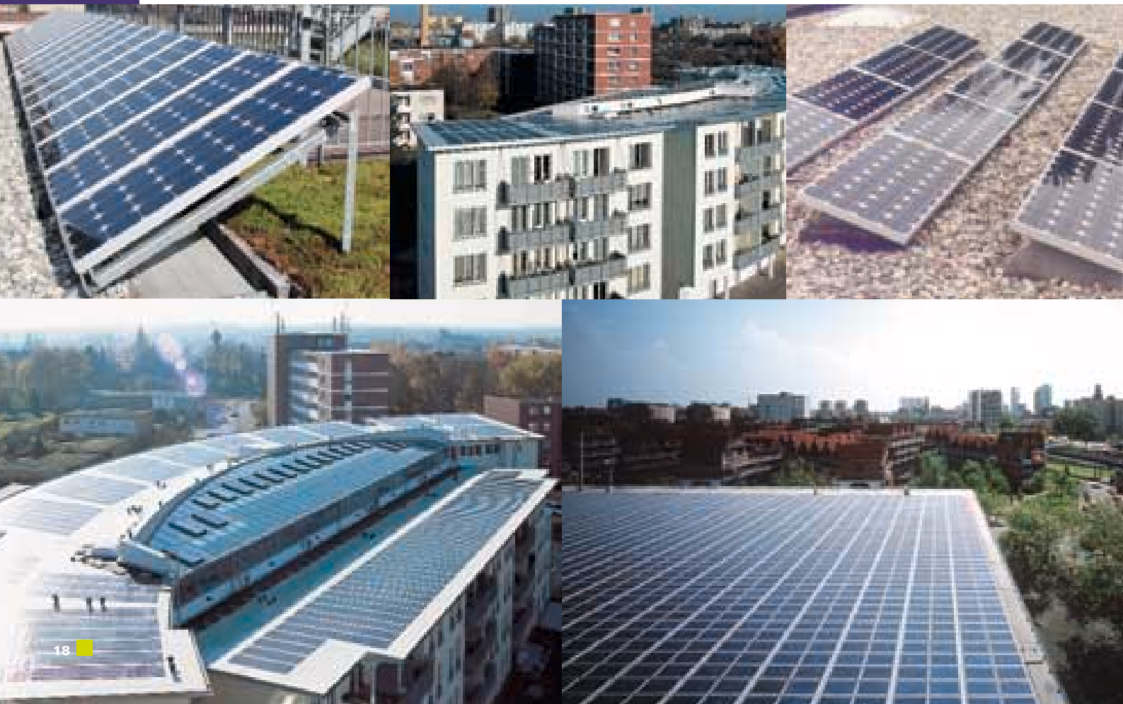
1. Antwerpen, België. Ecohuis (IZEN). 2. Braunschweig, Duitsland. Appartementen (Alwitra). 3. Mechelen, België. Kantoorgebouw (Solar Technics). 4. Braunschweig, Duitsland. Appartementen (Alwitra). 5. Rotterdam, Nederland. Gemeentearchief (SenterNovem, Hans Pattist).
