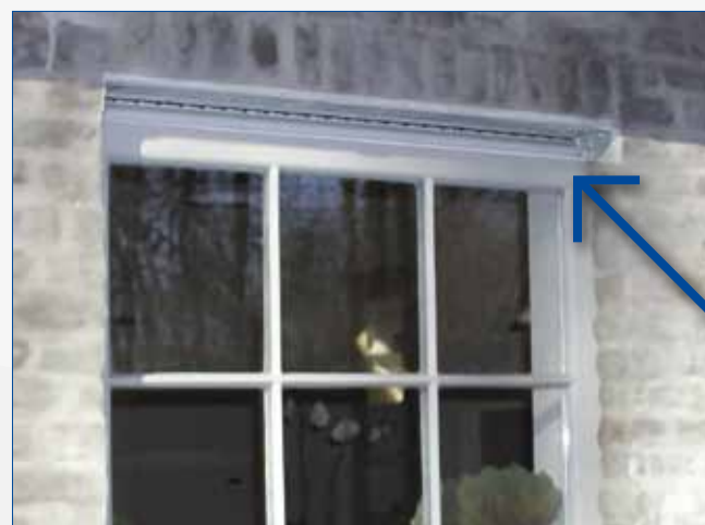
Amenée d'air naturelle via une grille de ventilation dans la fenêtre
