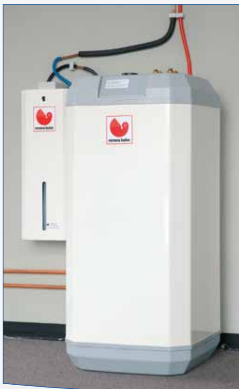
Ballon de stockage de chauffe-eau solaire avec chauffage d'appoint
