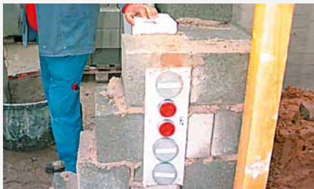
Ouvertures d'accès du coude de raccordement dans le mur de fondation
