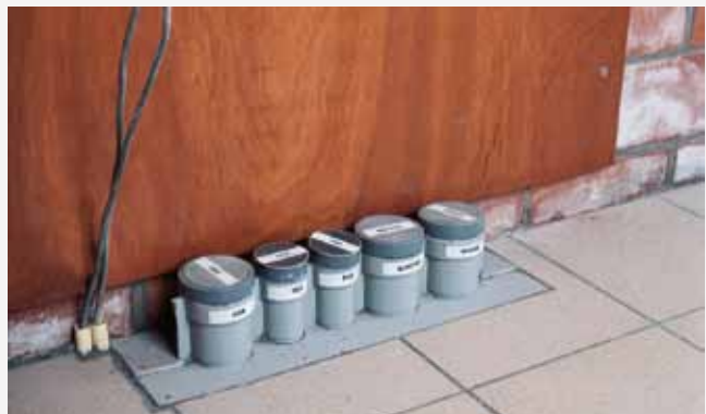
Toegangsopeningen van de aansluitbocht in de woning
